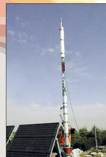
Instalación de un sensor sísmico de Sonseca que es Estación Primaria del Sistema Internacional de Vigilancia de Explosiones Nucleares de Naciones Unidas
