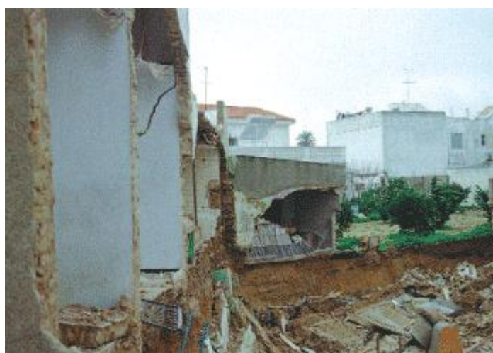
Daños en La Redondela (Huelva) por el terremoto de 20 de diciembre de 1989, de intensidad máxima VI, con epicentro en Ayamonte (Huelva)
