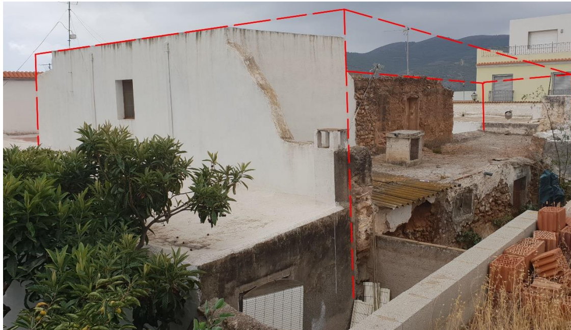
Ilustración 4-6 Parte posterior de la misma vivienda evidenciando el derrumbe y parcial recuperación de la planta superior.
