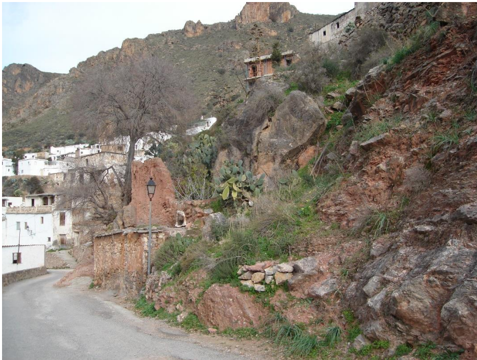
Ilustración 7-2 Antiguos tapiales afectados por derrumbes en Darrícal
