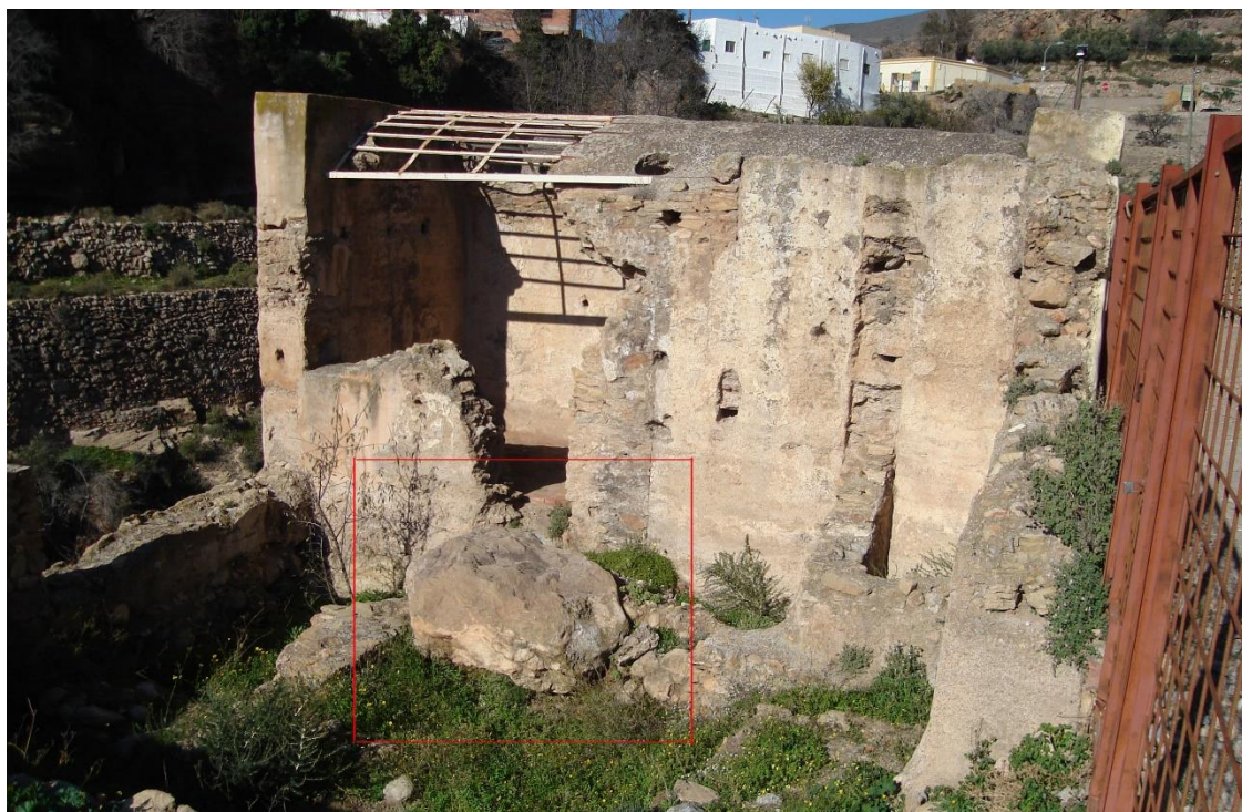
Ilustración 4-9 Baños de la Reina de Celín afectado por derrumbes del tajo
