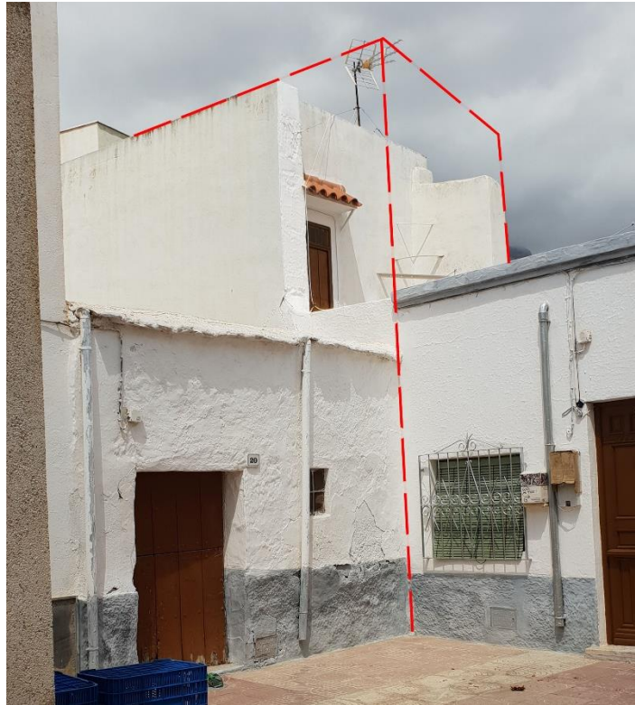
Ilustración 4-5 Vivienda en la Calle Padre Rubio de Dalías donde el testero de la planta superior ha sido reconstruido.
