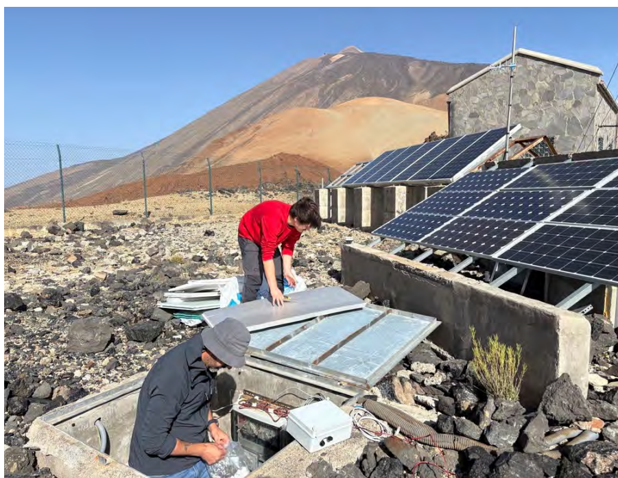
Personal del IGN procediendo a la instalación del inclinómetro IRAJ en las Cañadas del Teide
