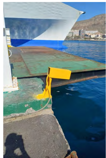
Nuevo sensor radar instalado en el Puerto de Los Cristianos.
