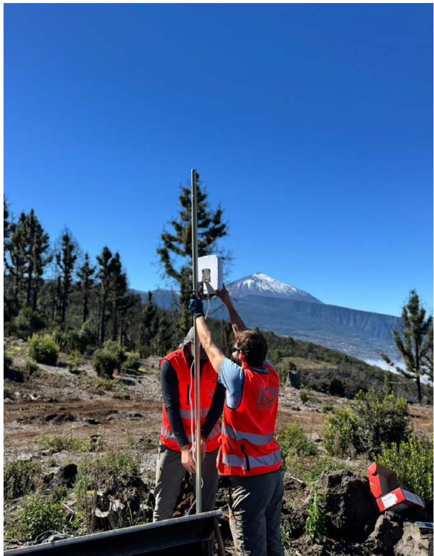
Personal del IGN instalando la antena de comunicaciones de la nueva estación en Santa Úrsula
