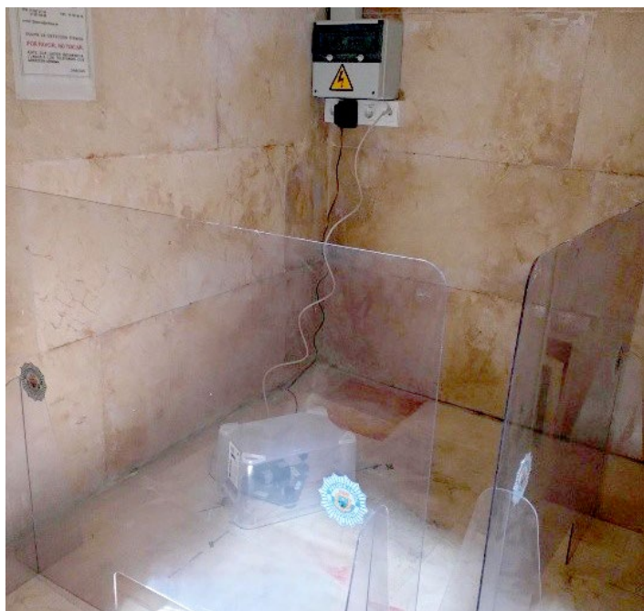
Acelerógrafo Sílex instalado en el sótano de la Comisaría de la Policía Local de Benidorm
