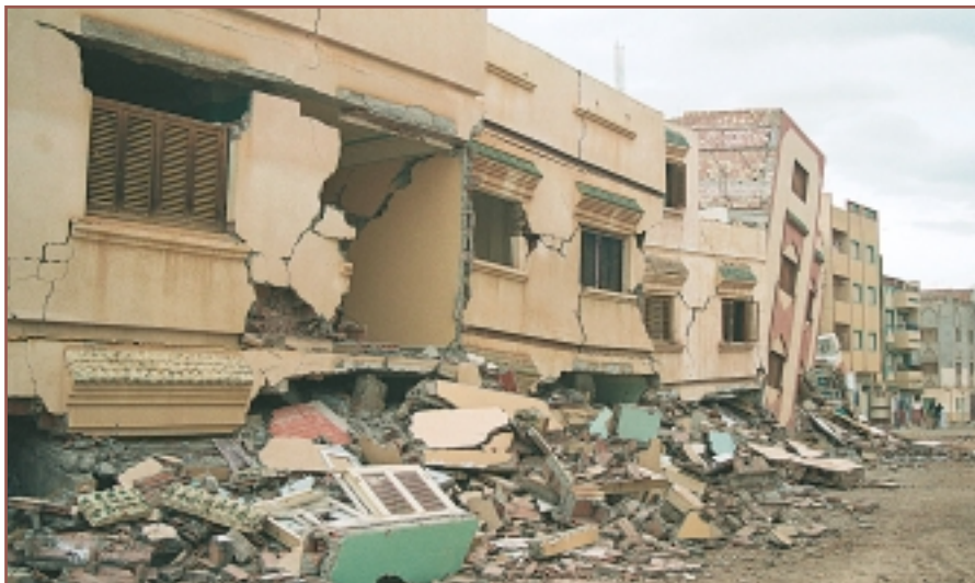
En ambas imágenes puede observarse el derrumbe de las plantas inferiores producido por el terremoto en la localidad de Imzouren.
