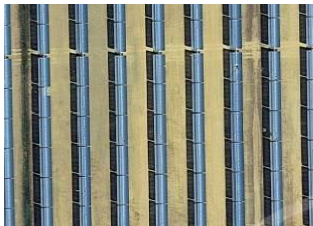
Detalle de elementos parabólicos en central termosolar
