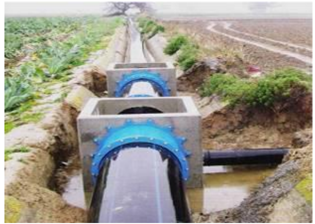
Tubería en superficie
