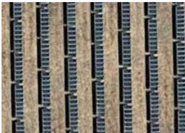
Detalle de paneles en central fotovoltaica
