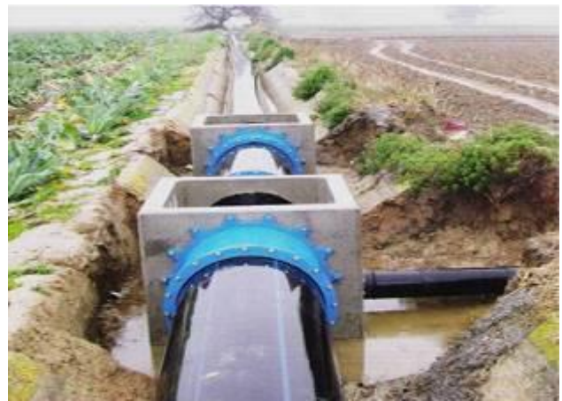
Tubería en superficie
