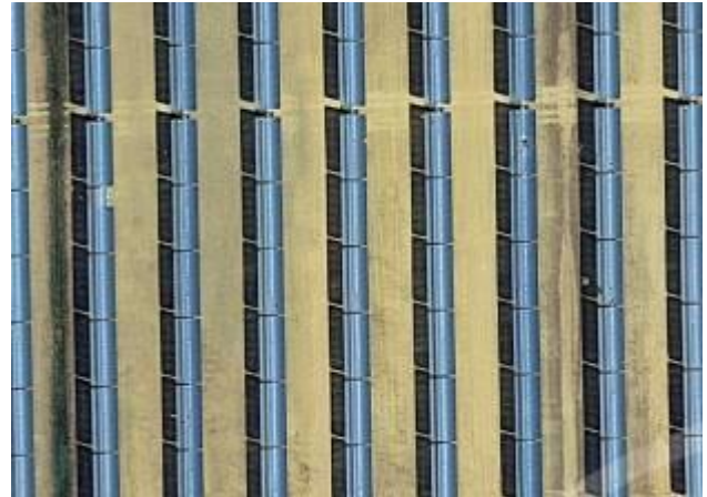
Detalle de elementos parabólicos en central termosolar
