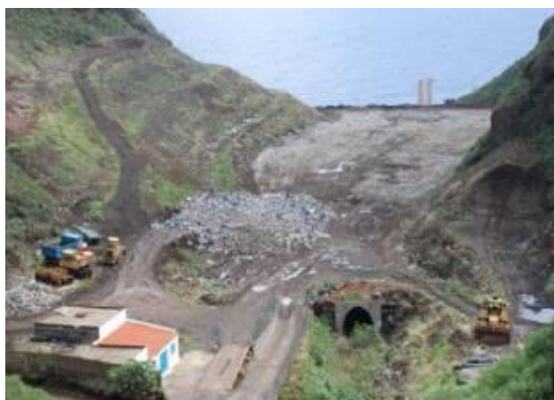
Vaso de residuos sólidos en explotación
