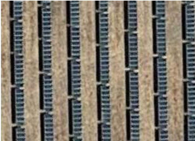
Detalle de paneles en central fotovoltaica
